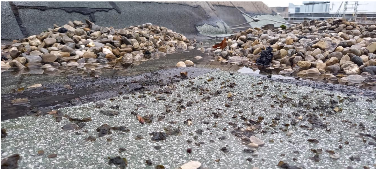
Detailaufnahme Dachhaut; stehendes Wasser aufgrund von fehlendem Gefälle und unzureichender Anzahl von Dachabläufen
