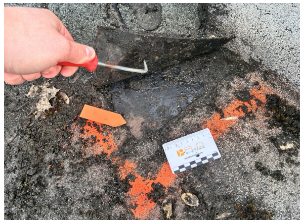
Bild 12 Defekt A2 Detail
