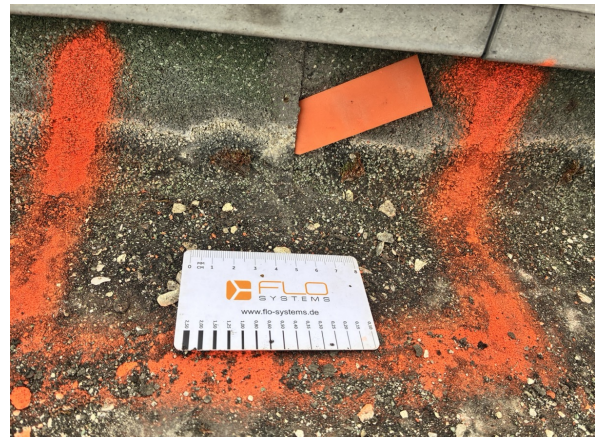
Bild 16 Defekt A4 Detail
