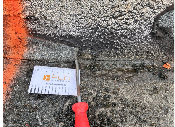
Bild 14 Defekt A3 Detail
