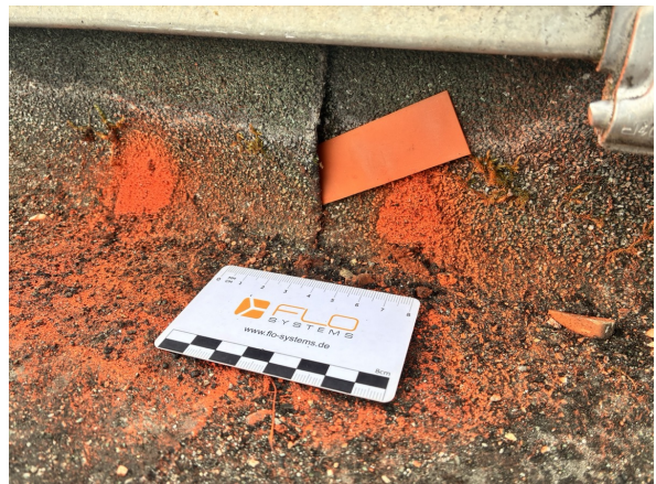
Bild 10 Defekt A1 Detail
